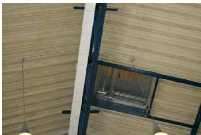
▲ In geval van grote warmte in het gebouw kunnen de bestaande dakluiken worden geopend voor extra natuurlijke ventilatie.
