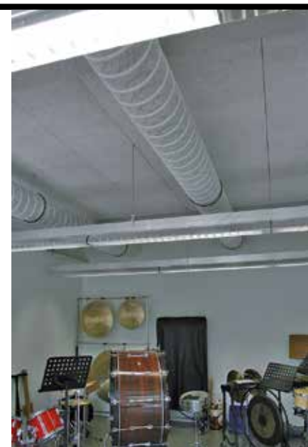
▲ Op de begane grond wordt in elke oefenruimte lucht ingeblazen via geperforeerde kanalen.
